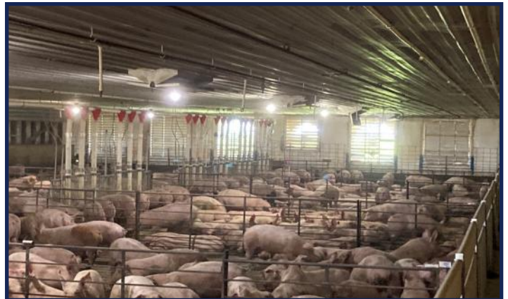
Tunnel Fan End
