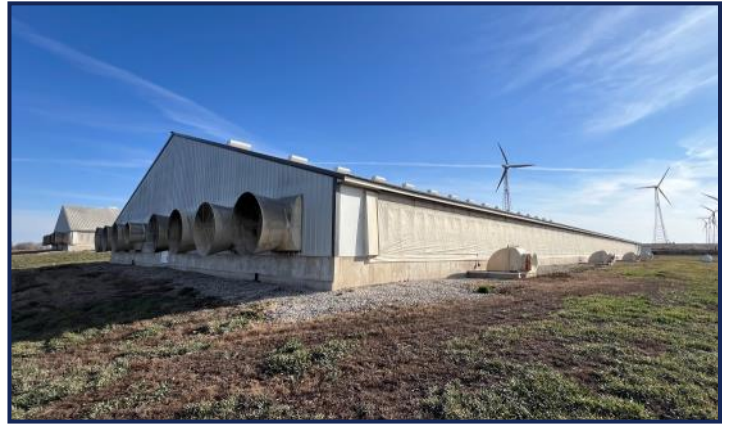
Tunnel Fan End
